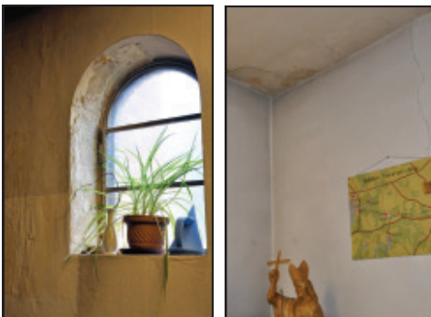
Oben: Die Sakristei in all ihrer „Pracht“ Unten: Schlimme Stellen an Fenster und Decke
